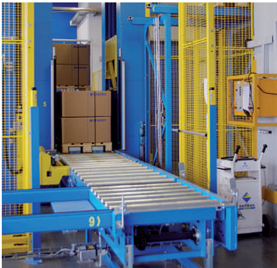
Ein fahrerloses Transportsystem gibt die palettierte Fertigware aus der Produktion zweilagig auf einen Kettenförderer auf
