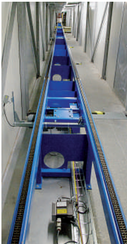
Die Automatisierung der 200 m langen Gesamtförderanlage geschieht mit dem AS-interface-Feldbus
